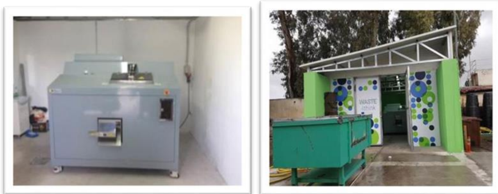
Σχήμα 3. Μονάδα ξήρανσης και τεμαχισμού τροφικών αποβλήτων στο Δήμο Χαλανδρίου
